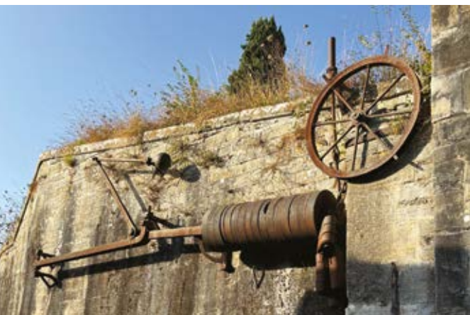
Les manchons de fonte du système de pont-levis dit à la Richerand-d'Obenheim à la petite porte d'Espagne.
